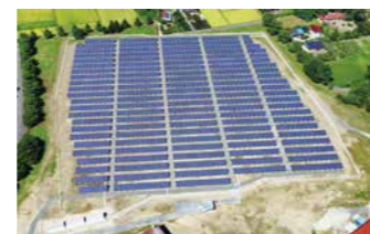
泉崎メガソーラー発電所
