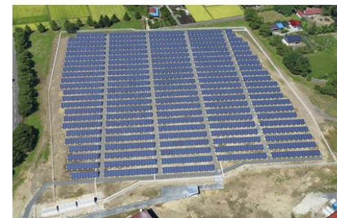
泉崎メガソーラー発電所
